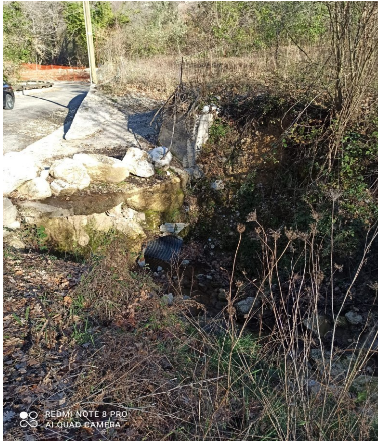
Foto n.7 - Attraversamento a valle da sistemare
