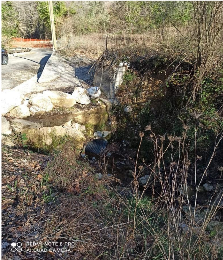
Foto n.7 - Attraversamento a valle da sistemare
